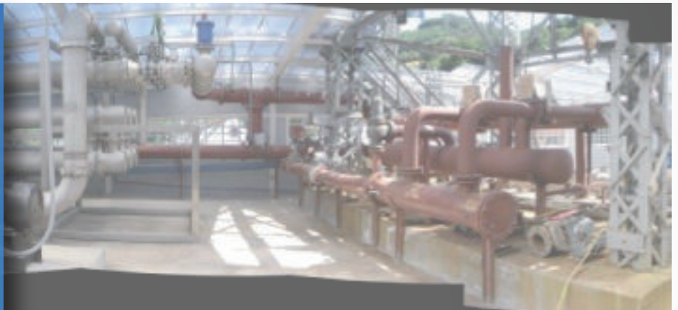
instalación de aprovechamiento geotérmico de HUNOSA (Barredo, Mieres), cortesía de HUNOSA
